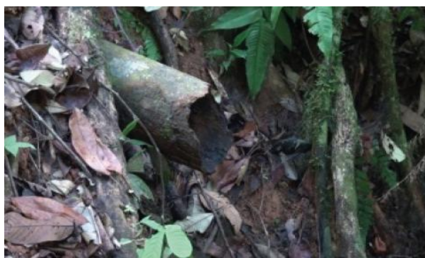
Photo : Tube col de cygne pour déversement dans l'estuaire. Zone du puits Aguarico 4. (12/09/2014)
